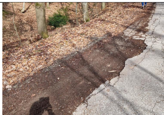
Schäden Eicherscheid´er Trift
